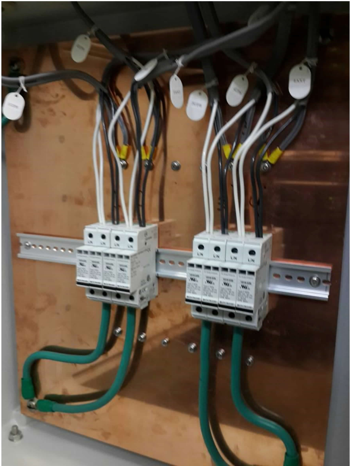
圖 12 UPS1~4 與天線 1~4 的接地
