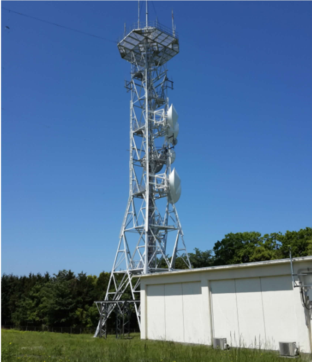
圖 6 機房旁的微波天線塔(中間)與機房外的 GNSS 天線(右下方)
