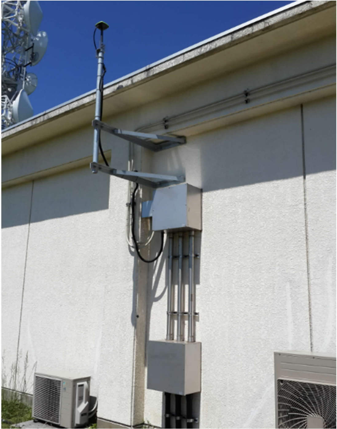
圖 7 機房外的 GNSS 天線及以金屬管套保護的電纜
