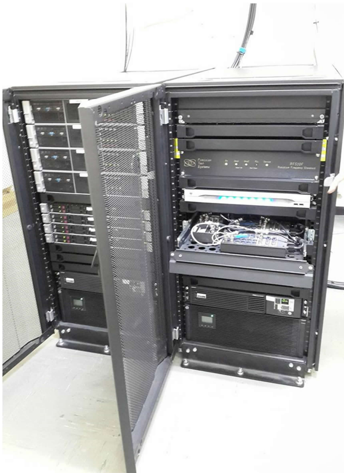
圖 8 機房內的 MEOLUT 設備機櫃
