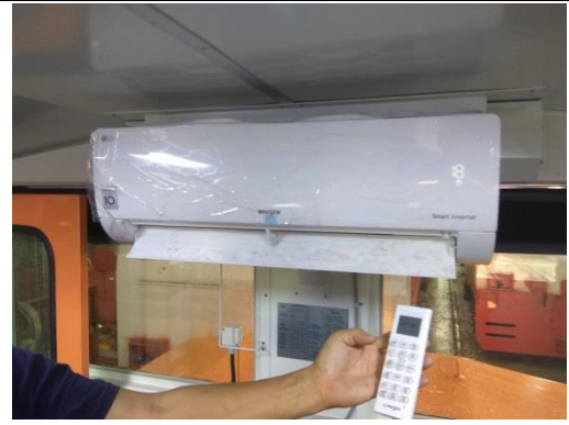
檢視空調設施
