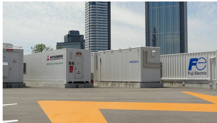
圖 24、NITE 大阪 NLAB 之 2MW 電源供應系統
