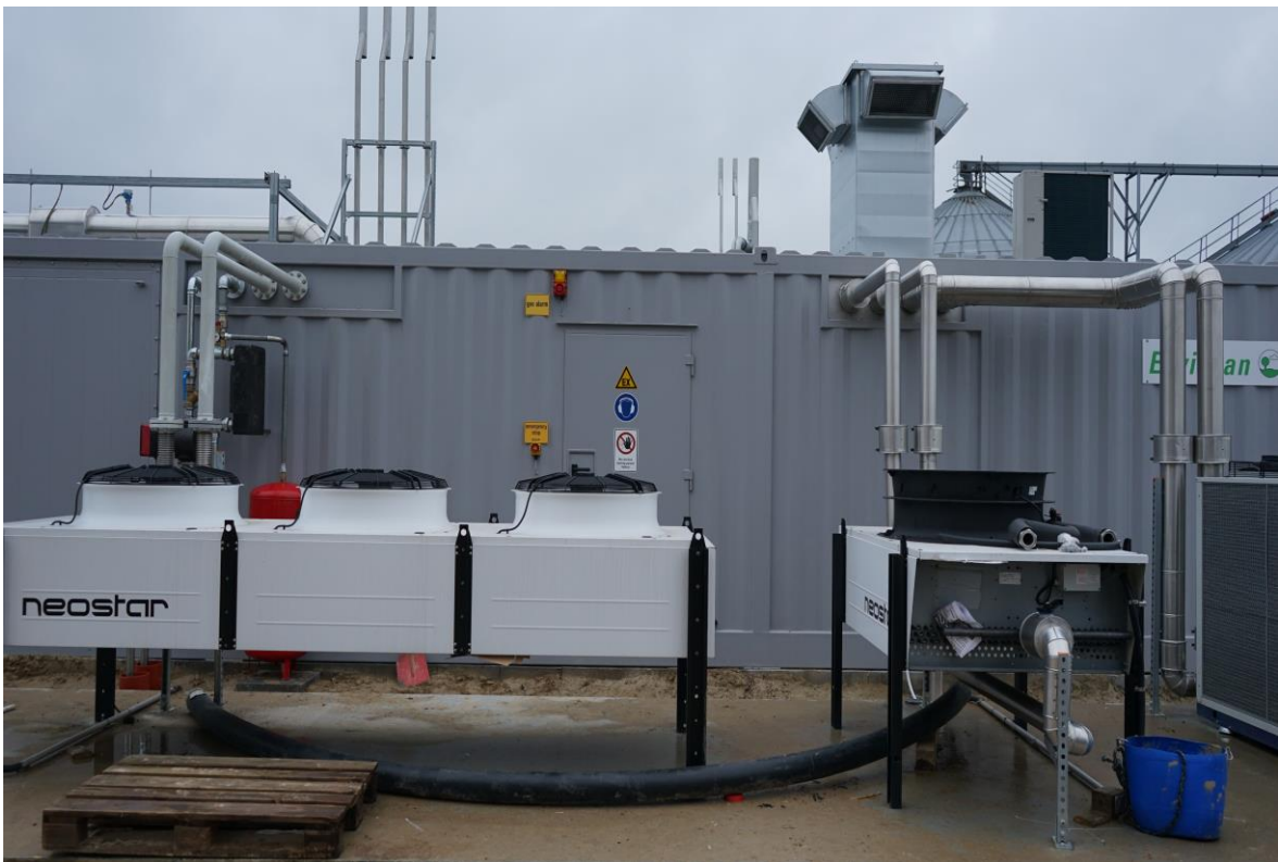
沼氣純化設備
