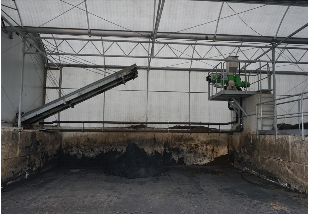
共發酵剩餘物 2 段式固液分離設備
