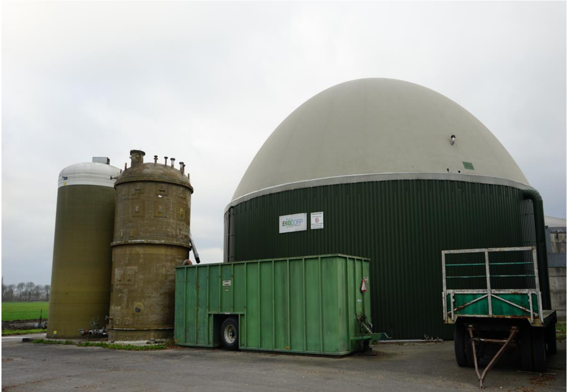
乳牛場附設場厭氧消化與沼氣收集、利用設備
