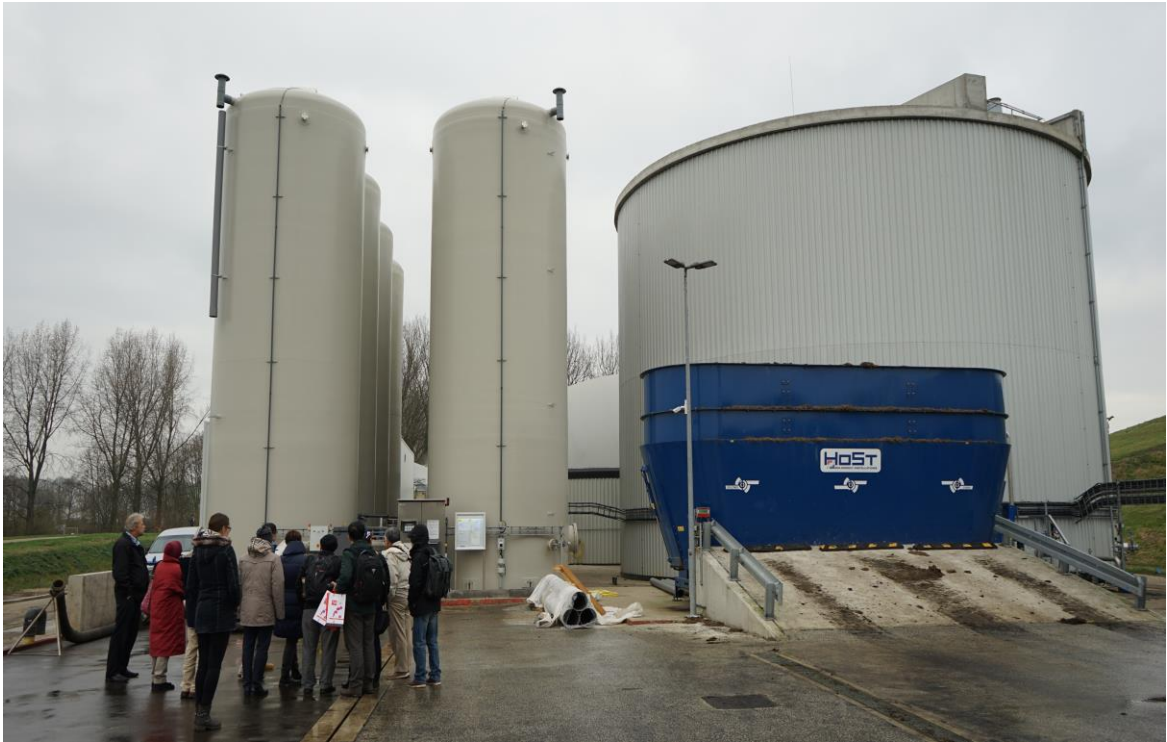
共同處理場厭氧消化與沼氣收集、利用設備
