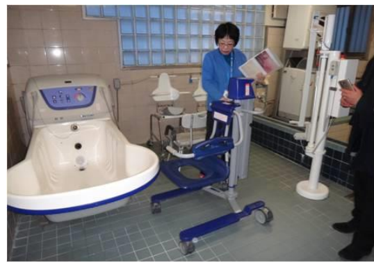
日間服務中心衛浴設備提供長輩洗澡服務
