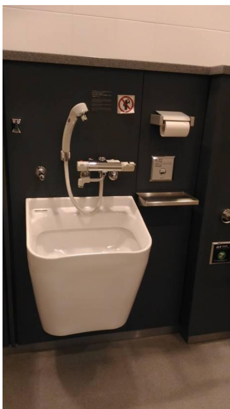
圖75、多功能廁所內部洗滌盆
