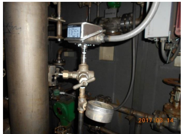
圖 83 CT-1 噴水泵出口壓力開關
