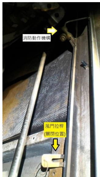
圖 48 氣機房 B2 側風門消防未定位
