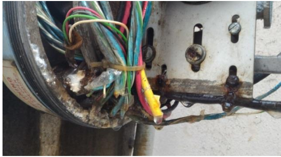
圖 94 #C 槽水位機傳送器內部長期積水
