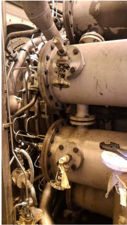
圖 31 未裝上 Flame Scanner 情況
