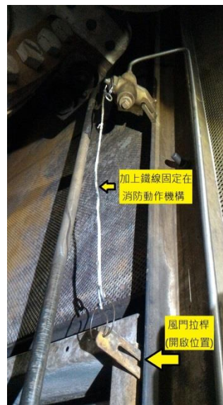
圖 49 氣機房 B2 側風門消防定位後
