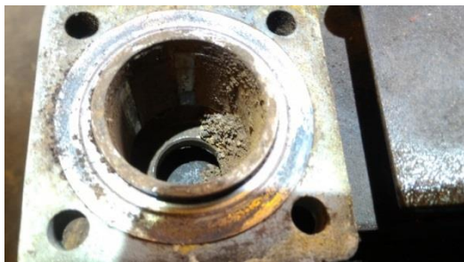
圖 36 VA17-5 閥內泥沙沈積
