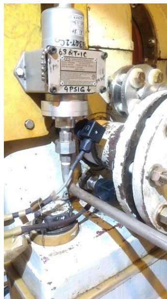
圖 10 CT2 發電機 GJ-1/2 安裝完之外觀
