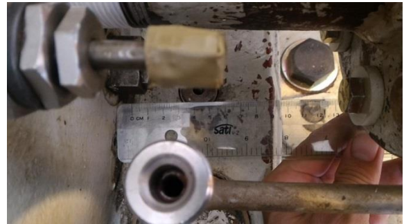
圖 7 CT2 發電機 RTD 裝設位置狹小
