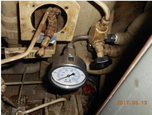
圖 69 CT-1 增設燃油泵出口壓力表
