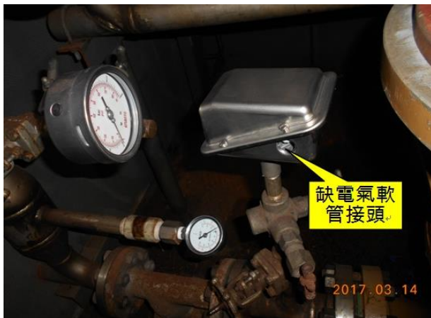
圖 82 CT-1 噴水泵入口壓力開關
