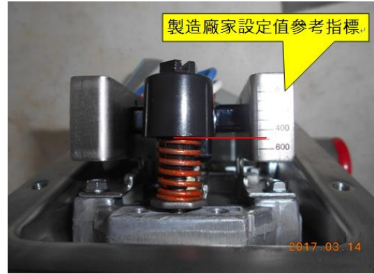
圖 85 噴水泵出口壓力開關暫設設定值
