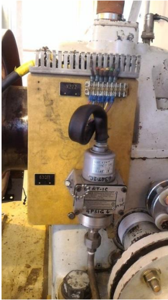
圖 14 CT2 63QT-1C 安裝位置
