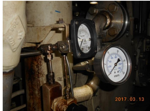
圖 70 CT-2 增設燃油泵出口壓力表
