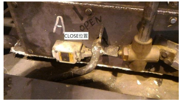
圖 47 屋頂排風扇開關機構(CLOSED)
