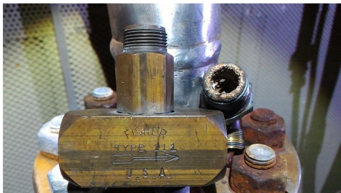
圖 88 CT-2 Water Injection SV2 上方針閥洩漏
