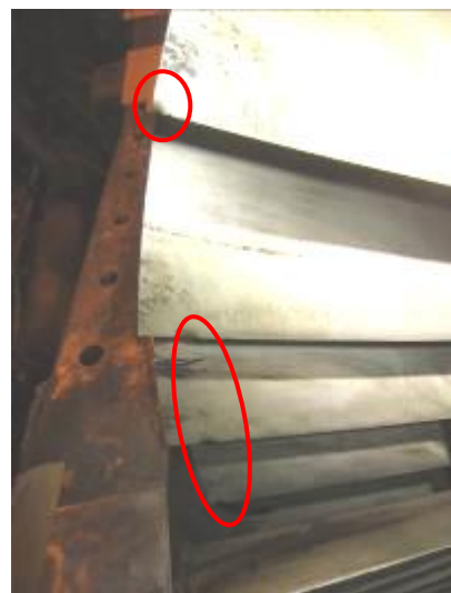
照片 6：空壓第 0 級動葉 4 只凹陷瑕疵
