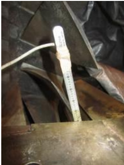
照片 9：空壓機動葉徑向間隙量測
