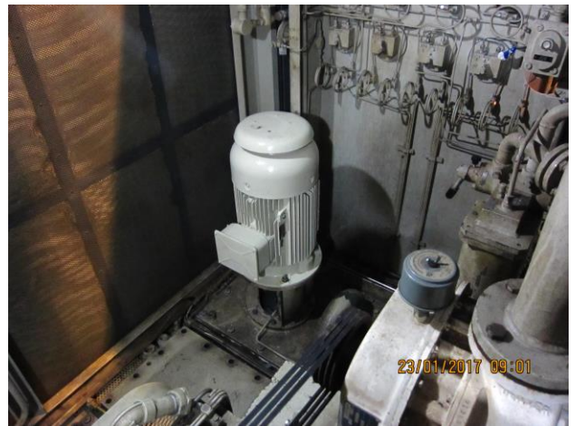
照片 34：輔助潤滑油泵組裝
