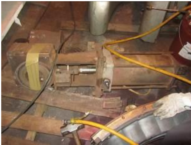
照片 39：氣機冷卻空氣逸放閥測試發生洩漏
