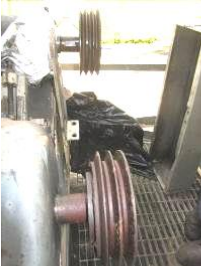
照片 43：排風扇皮帶輪破損
