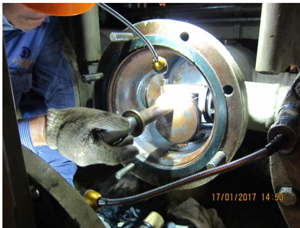
照片 45：潤滑油冷卻器切換器檢查
