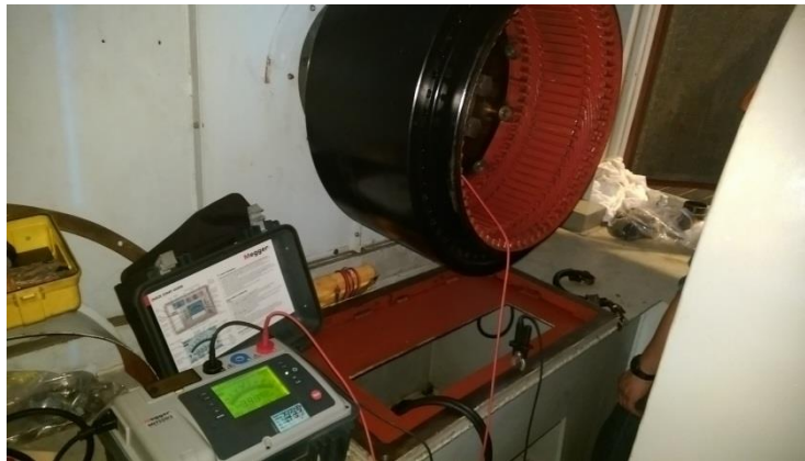
圖 2.4.2 發電機轉子的絕緣測試
