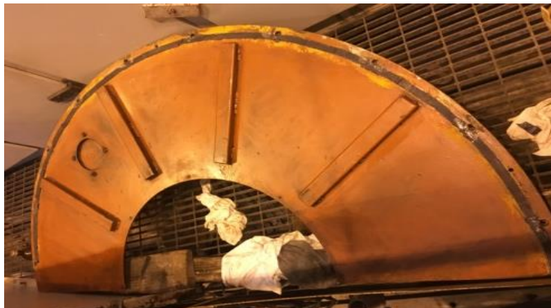
圖 2.2.10 發電機勵磁機側外蓋上半部
