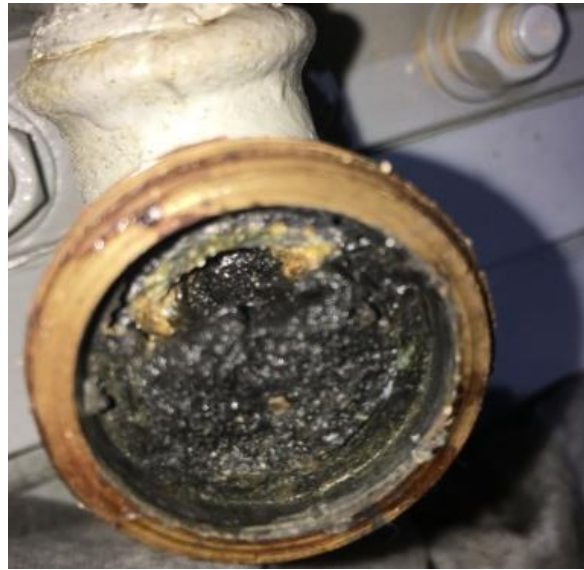
圖 2.7.5 水垢嚴重堵管情形
