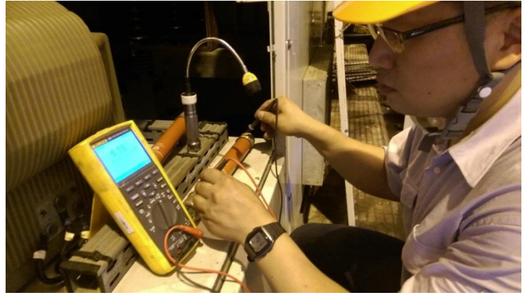
圖 2.3.5 AVR PT Fuse 電阻量測
