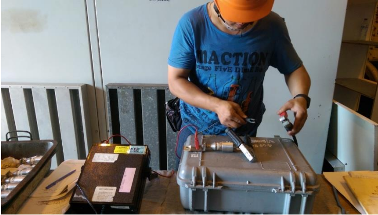
圖 2.1.4 勵磁機整流模組的洩漏電流測試
