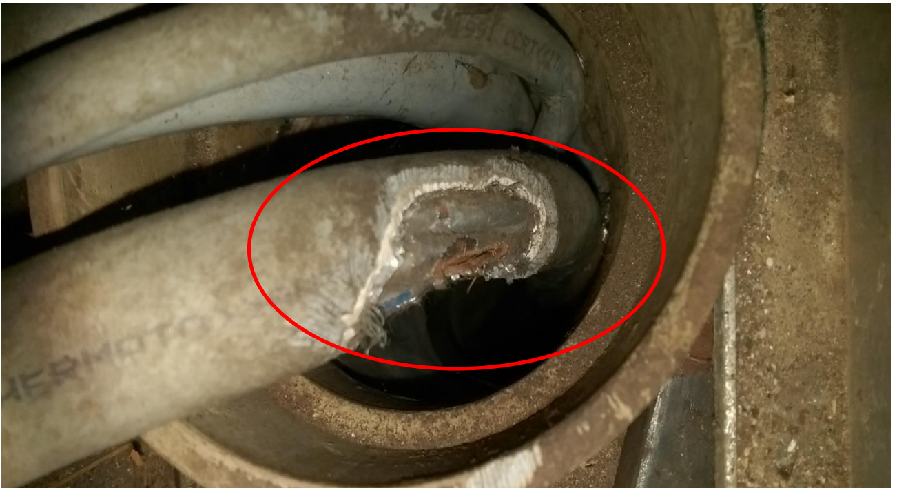
圖 2.5.4 CT#1 Gen. Stator Winding RTD X211 量測， 查線結果發現疑似被老鼠咬破皮痕跡
