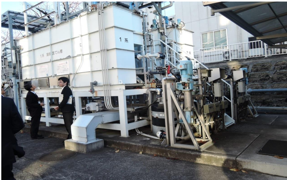
圖 14 東京都水道局教育訓練設施淨水處理場地實習場(100CMD)
