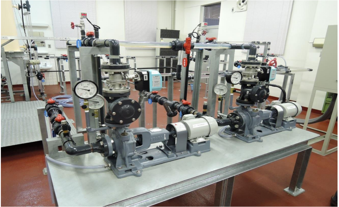
圖 60 大阪水道局職員研修所管線操作設備訓練場地
