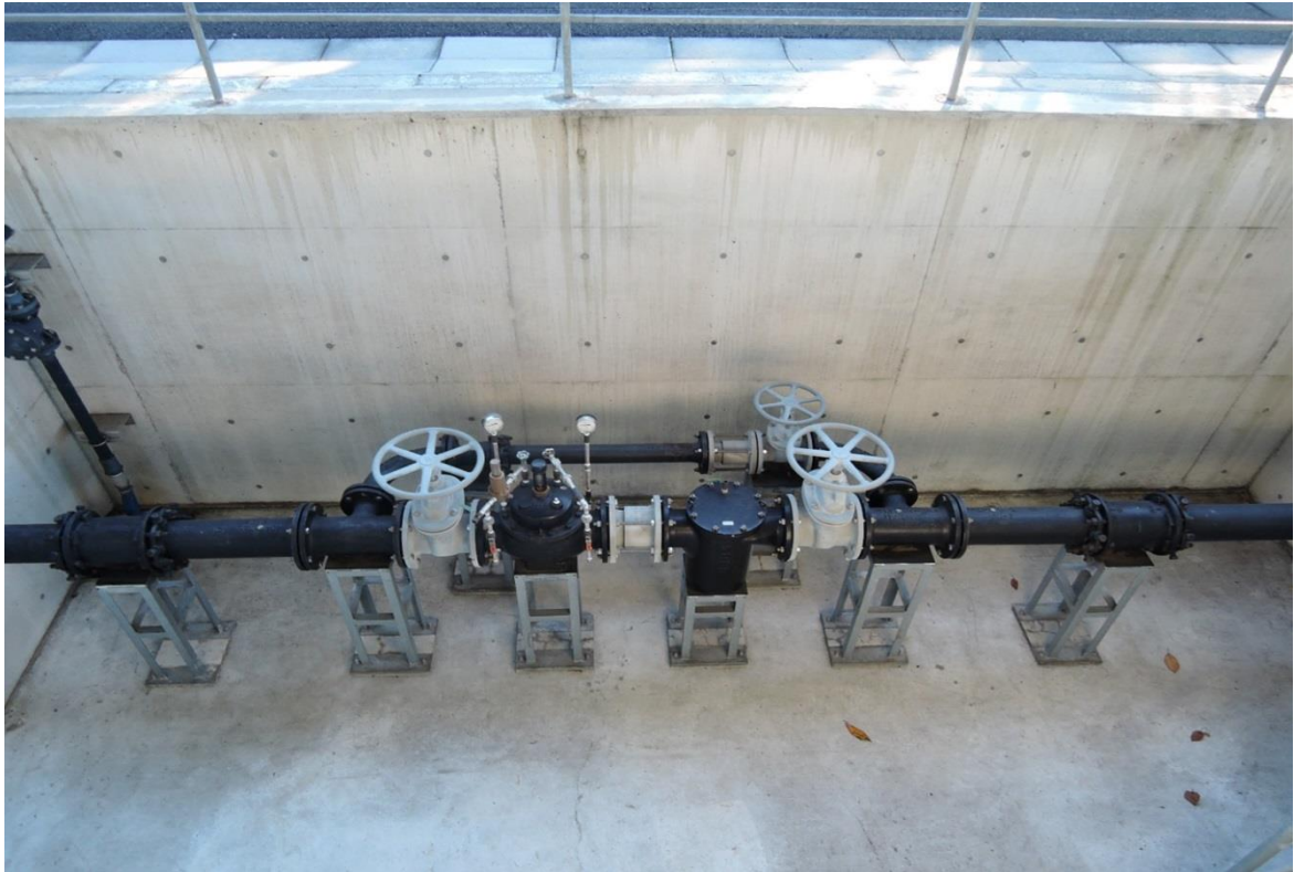
圖 21 東京都水道局教育訓練設施減壓閥安裝實習場
