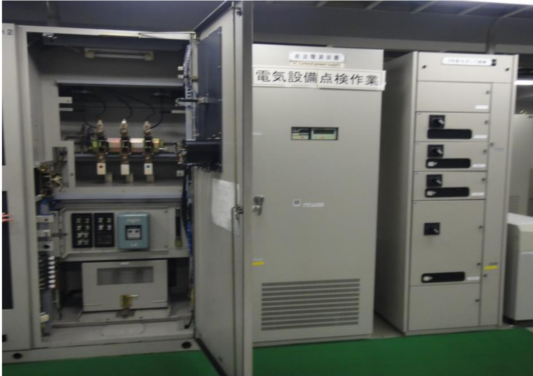
圖 7 東京都水道局教育訓練設施電氣研習室
