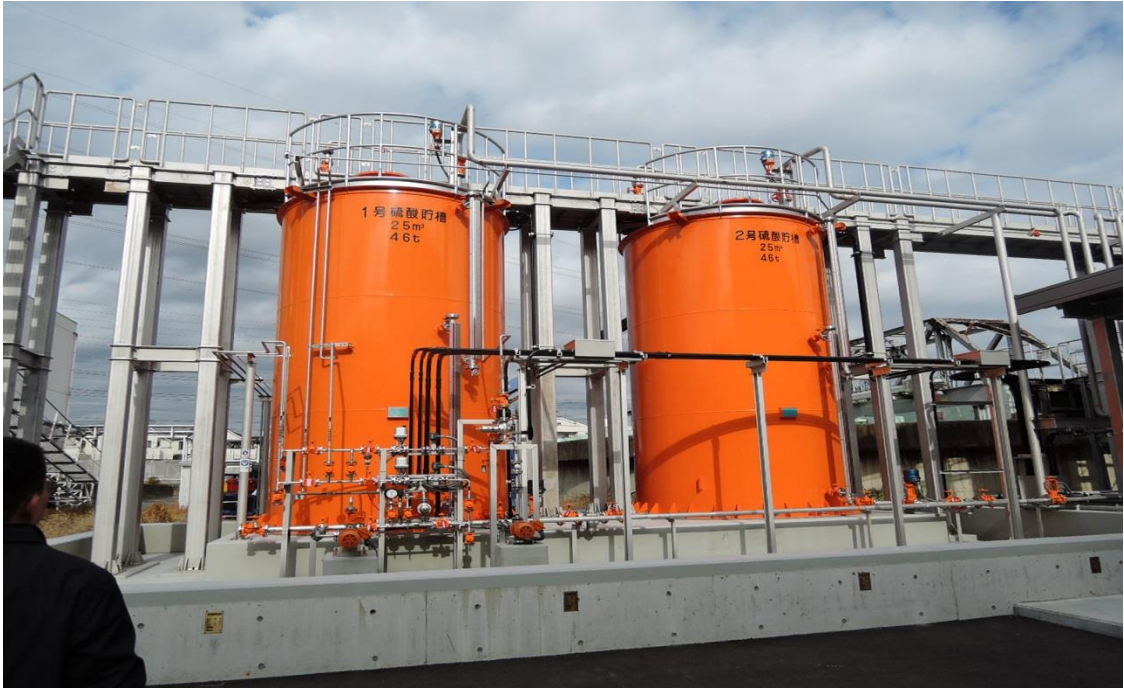
圖 30 東京都水道局東村山淨水場加藥系統
