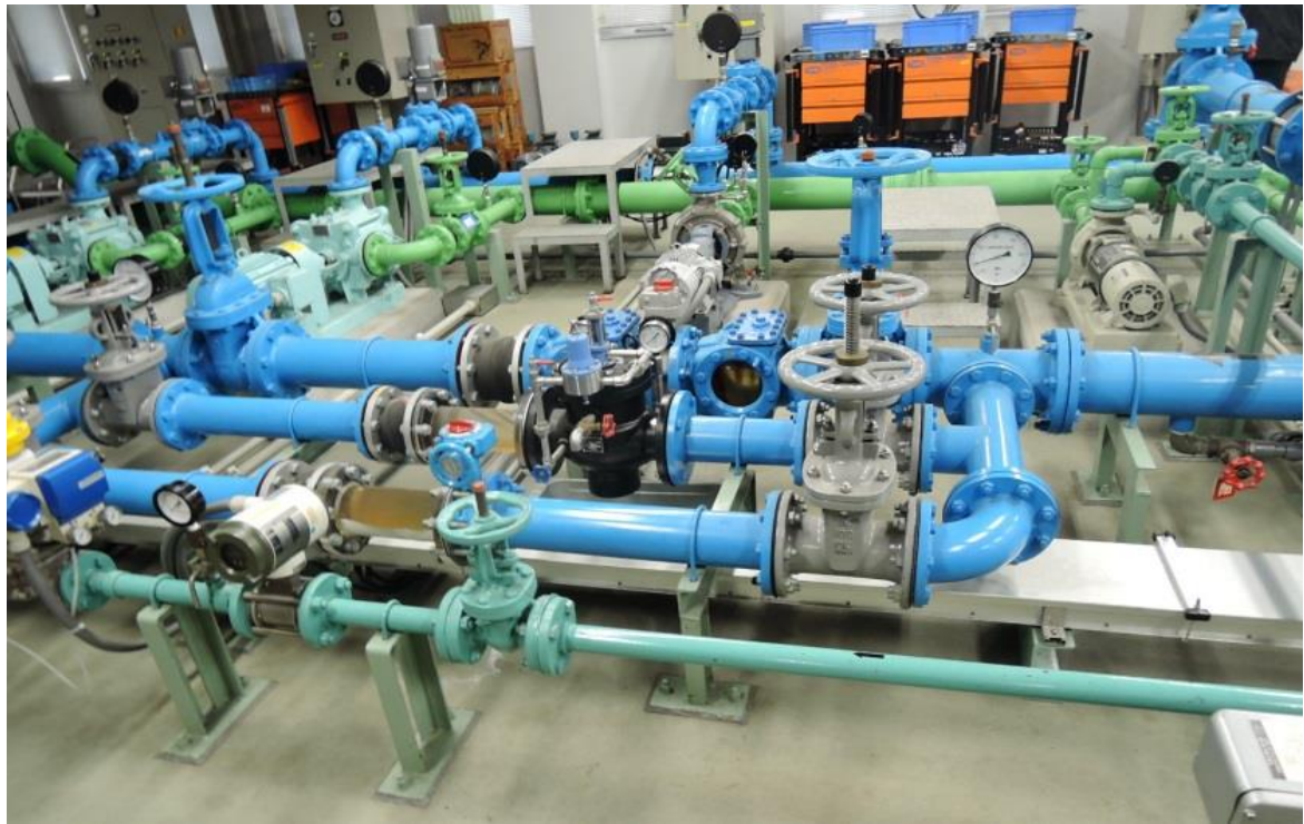
圖 9 東京都水道局教育訓練設施管線閥類配置、抽水機訓練室
