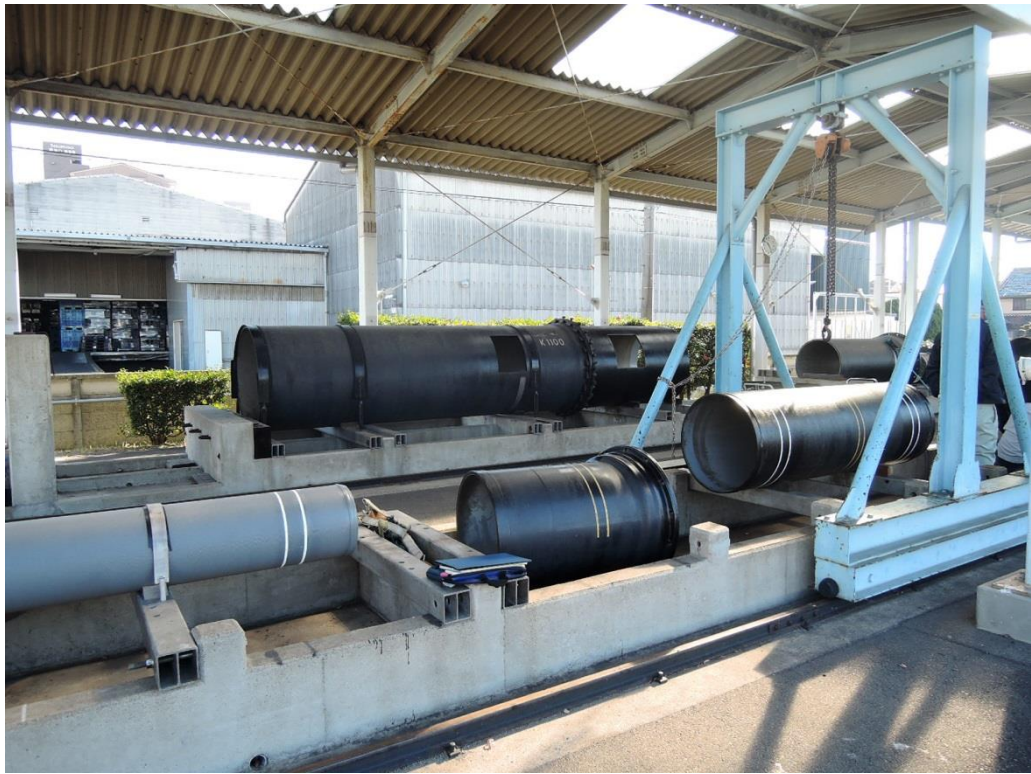
圖 46 名古屋市上下水道局職員研修所大口徑訓練場
