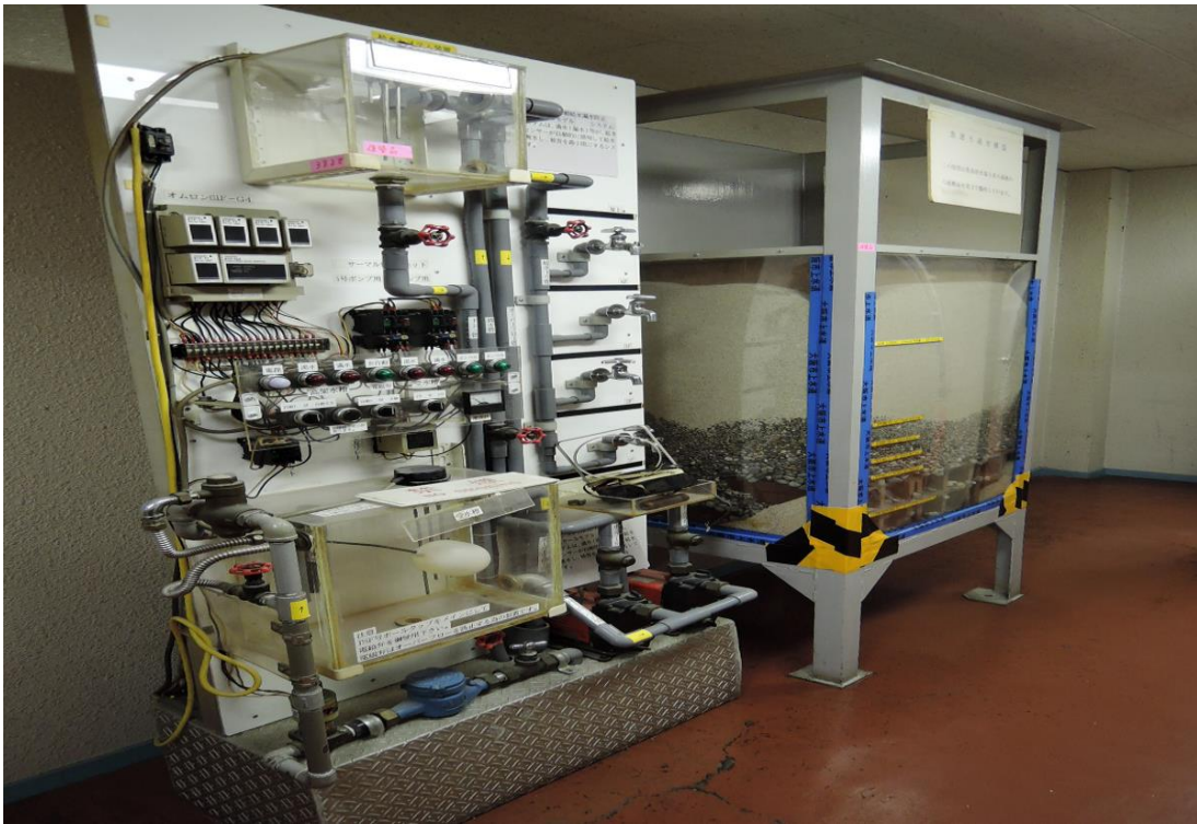
圖 59 大阪水道局職員研修所機械設備訓練場地
