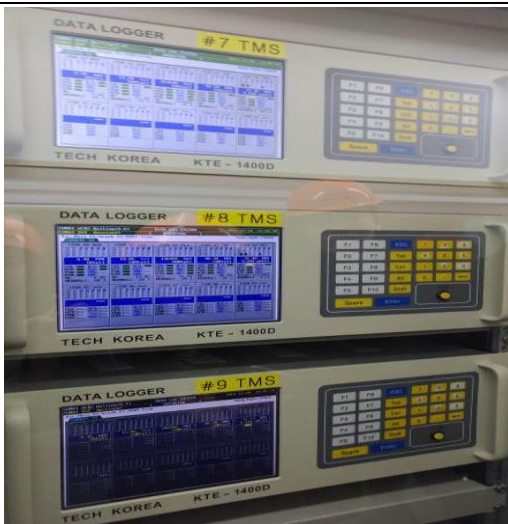
浦項集團仁川發電廠 TMS 站房監測數據記錄傳輸器
