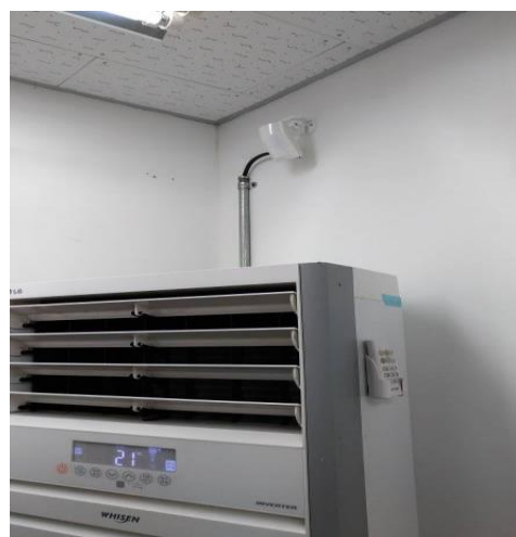
浦項集團仁川發電廠 TMS 站房人員進出感應器
