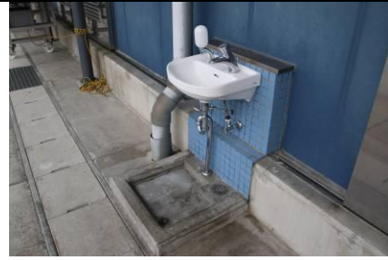
船員與承銷人洗手消毒池
