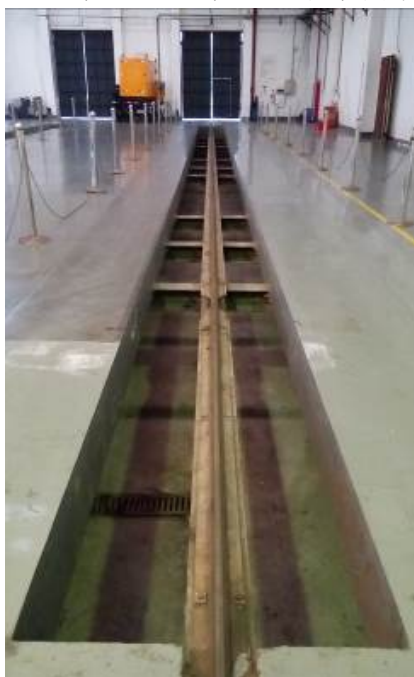
圖 61 維修車庫及維修坑道(大陸改良)
