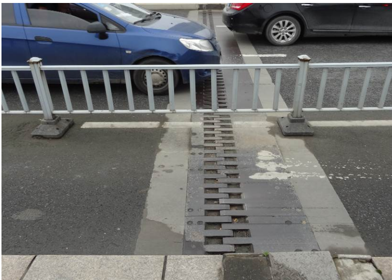
圖 135 長豐橋之橋梁伸縮縫
