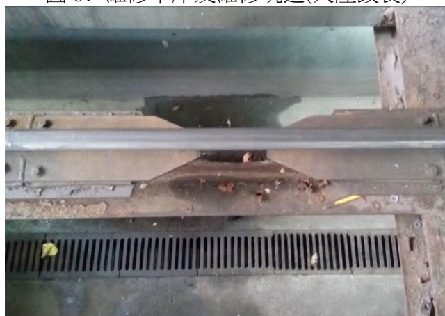
圖 62 維修車庫更換導輪處鋼軌缺口
