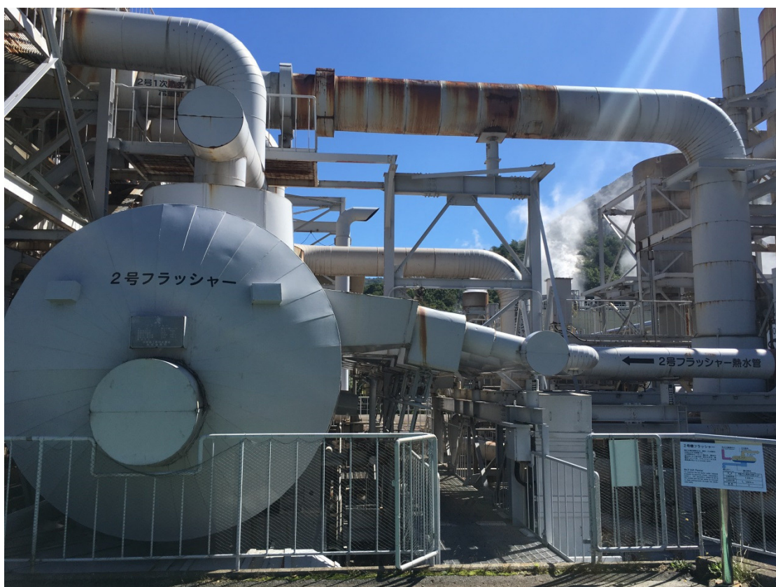
照片 7、八丁原地熱発電所閃發器
