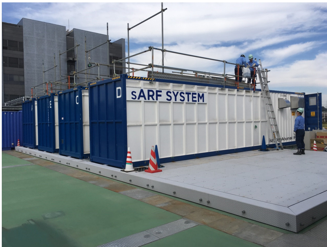
照片 19、住友電工橫濱工廠貨櫃型儲能系統
