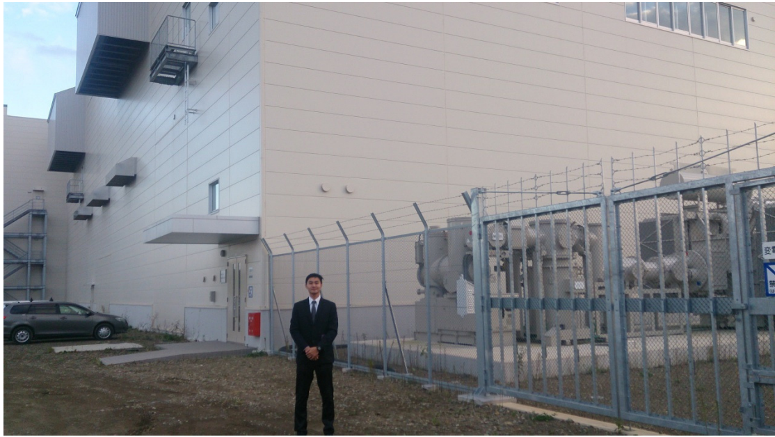
照片 20、南早來變電所儲能示範廠
