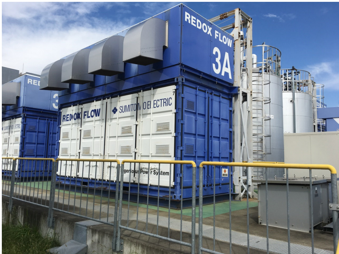
照片 17、住友電工橫濱工廠儲能系統
