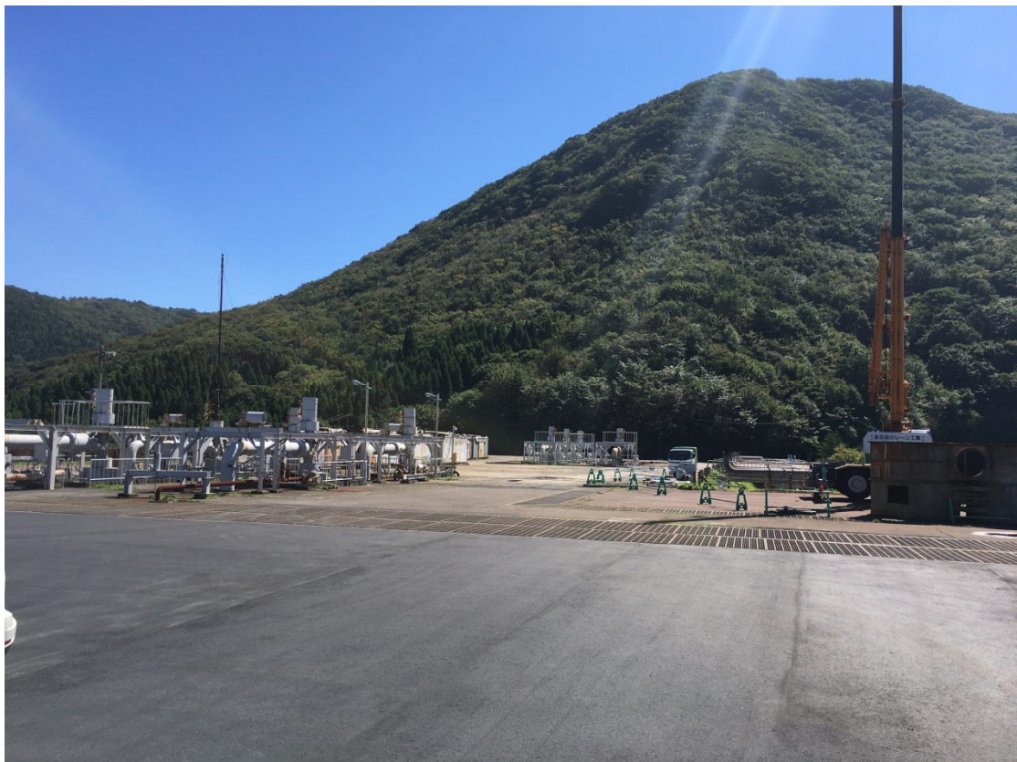
照片 9、八丁原地熱發電所 13 號生產井基地
