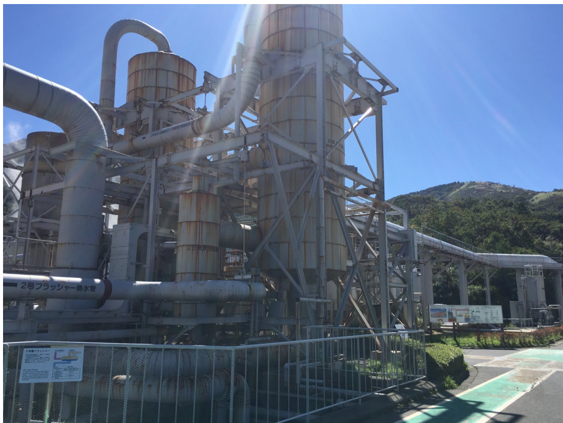
照片 6、八丁原地熱発電所汽水分離器
