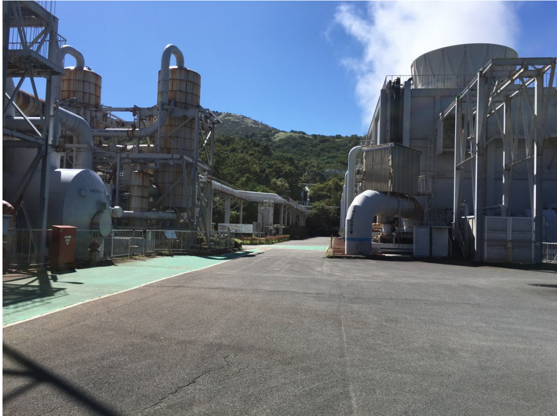
照片 8、八丁原地熱發電所冷卻塔
