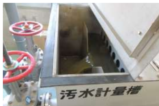
D. 污水計量槽
