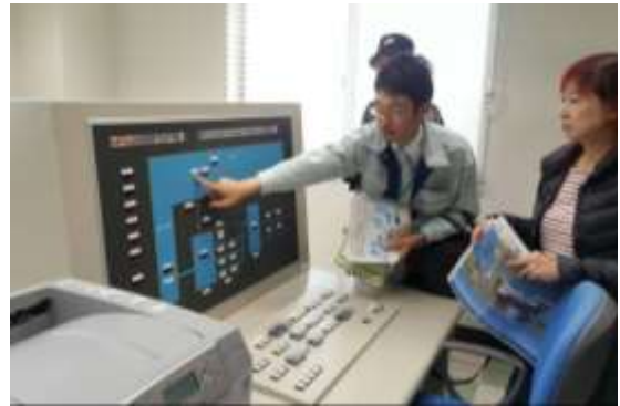
D. 自動控制監測設備
