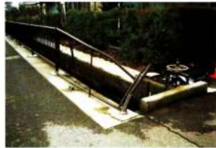
(事故によるフェンスの損傷)
