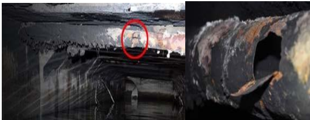
圖 17 4 吋丙烯管線及破裂開口
