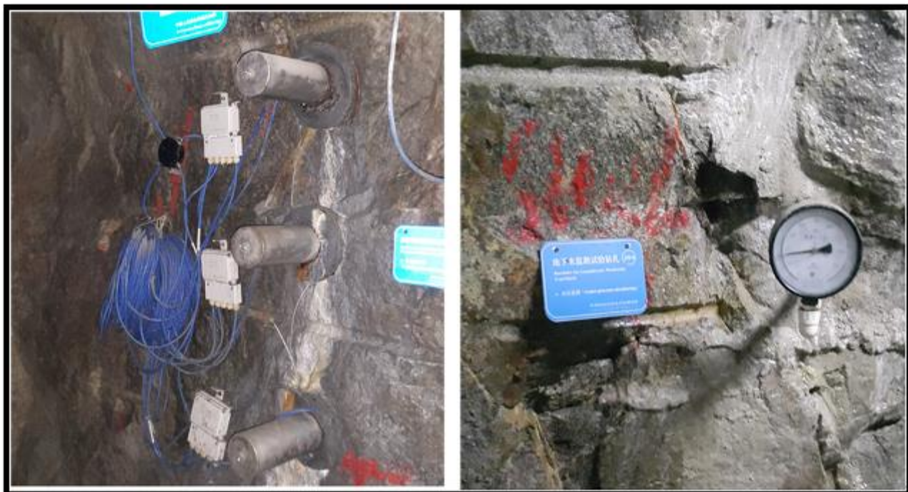
圖 17：探坑試驗設備：圍岩變形監測試驗區(左)、地下水監測試驗鑽孔(右)
