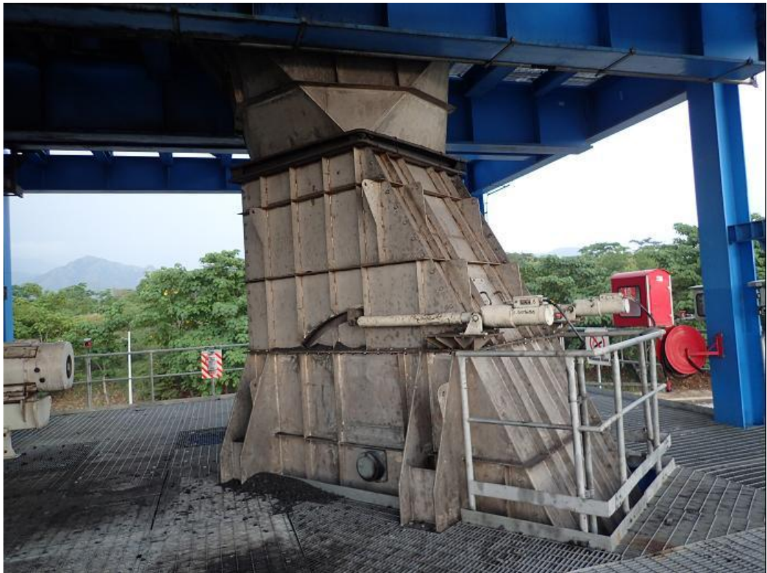
圖151 Puerto Nuevo裝煤碼頭取樣設備
