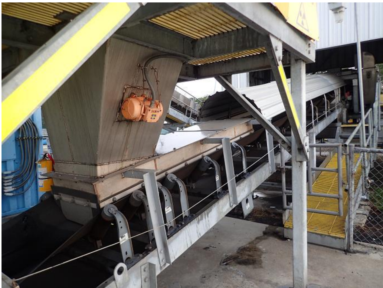
圖155 Puerto Nuevo線上即時分析設備
