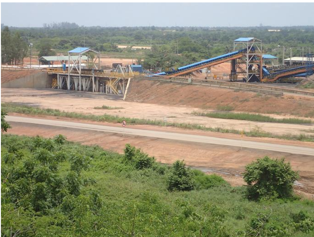
圖134 Prodeco礦區卡車卸煤站
