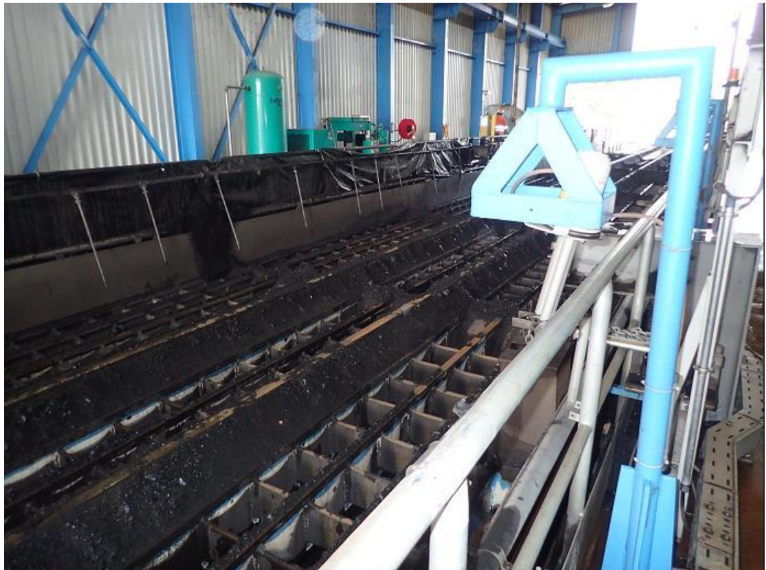
圖145 Puerto Nuevo裝煤碼頭火車卸煤站
