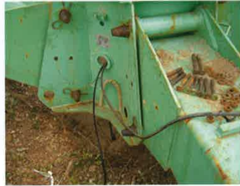
圖 26 配線電纜佈線
