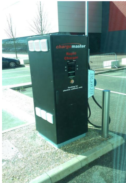
2016/04/26 參訪智慧城市 Milton Kynes 電動巴士之電源設備、臨停站 之無線充電現場及接線式充電設備
