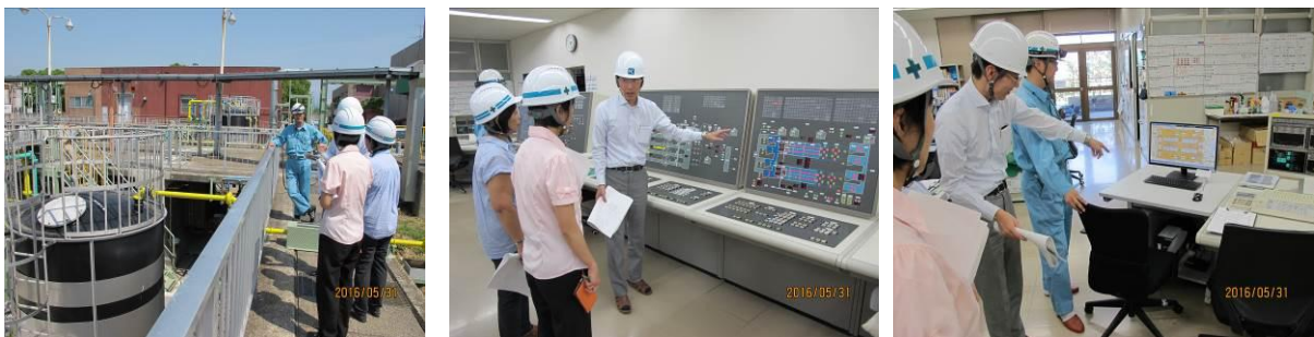
圖 13 MBR 系統化學藥槽區及中控室
