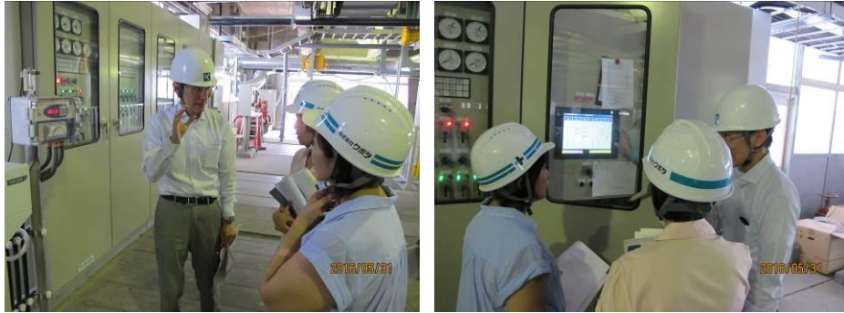
圖 12 MBR 出流水質監測儀器及現場控制盤
