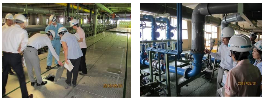
圖 11 膜過濾槽及產水泵浦
