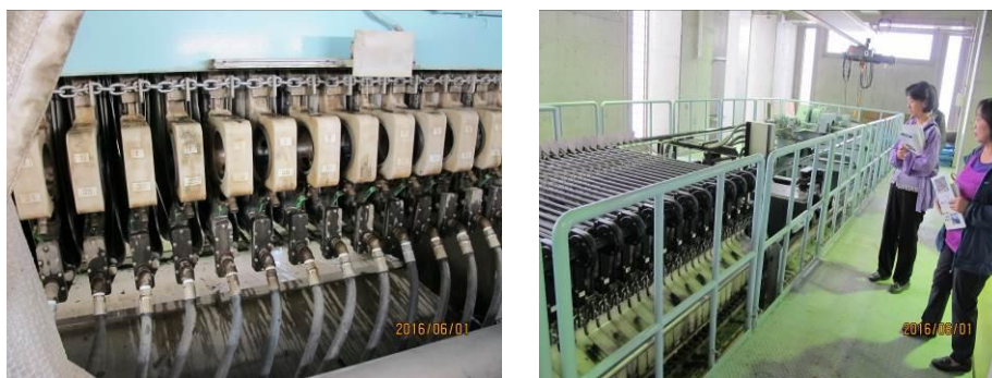
圖 18 板框脫水機開板脫水
