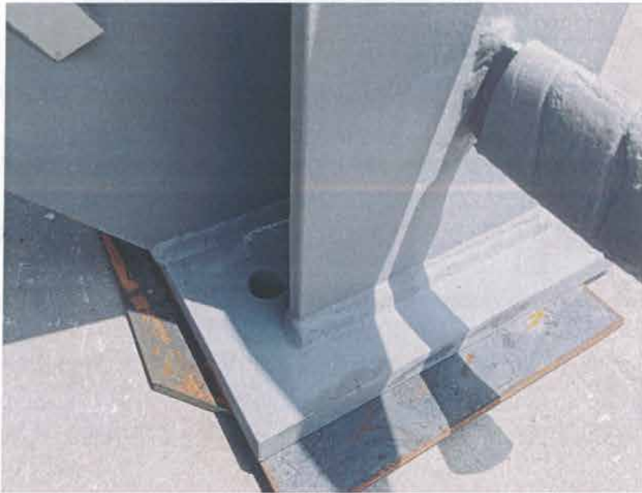
空冷器支撐鋼構銲道品質良好
