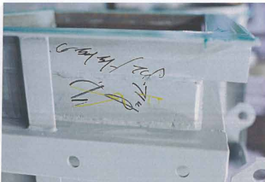
本案加熱爐煙道鐸道目視品質不良，已請廠商改善
