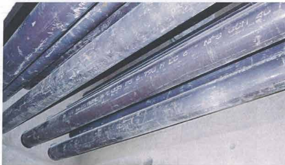
本案加熱爐對流區爐管
