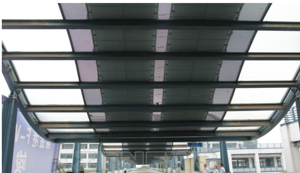
圖 三十六：浙江大學紫金港校區東教學樓走廊薄膜太陽能電池
