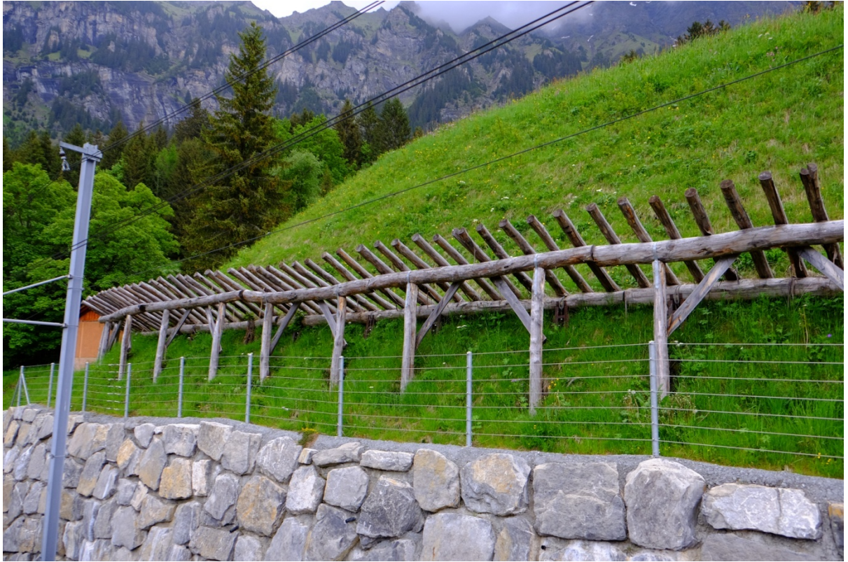
圖 41 高山火車邊坡之防落石柵
