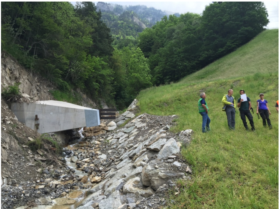
圖 17 土石流破壞壩(類似丁壩型式)
