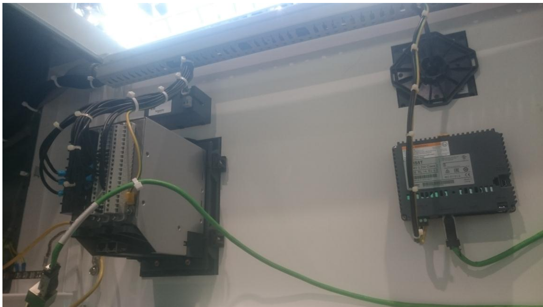
圖 25 現場開關箱內部
