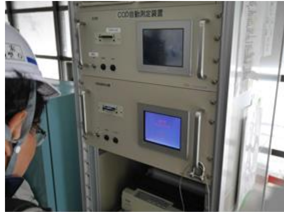
COD 自動監測設備
