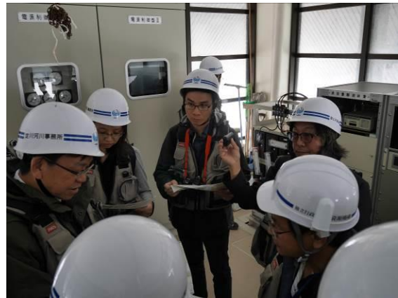
自動觀測站內部
