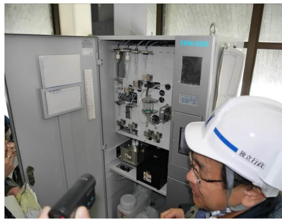
總氮與總磷自動監測設備
