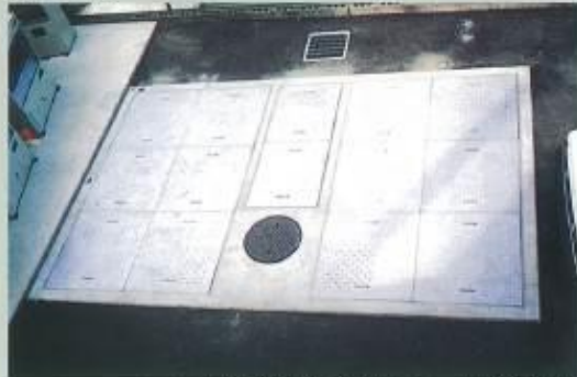
▲大阪東部生協配送センター汚水処理施設
