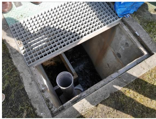
消毒槽及放流槽
