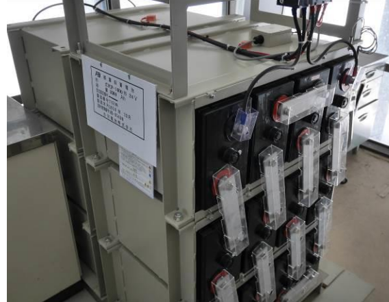
太陽能儲存電池
