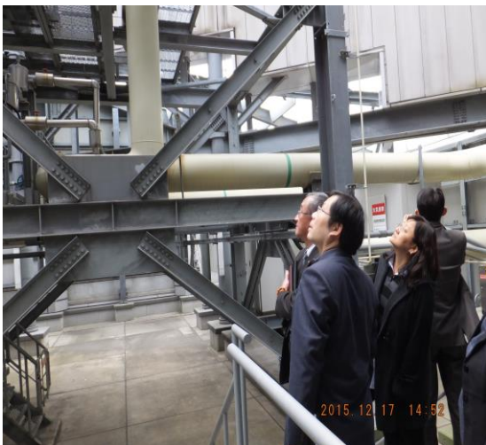
圖 34、位於建物頂樓的大型整合空調系統
