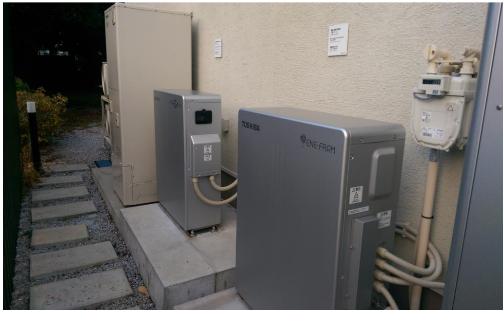
圖 14、東芝公司智慧節能屋所使用燃料電池系統
