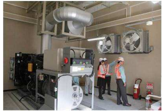
圖 3.4.1-6 隧道機房發電機
