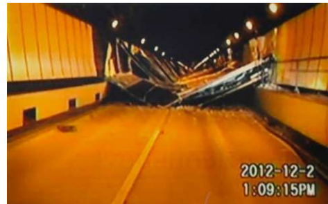
圖 3.4.2-4 笹子隧道崩塌情形
