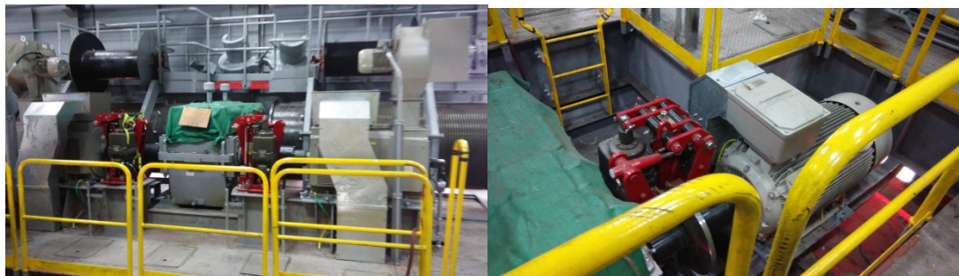
圖 2.2-16 橋式貨櫃起重機機房內配置照#2
