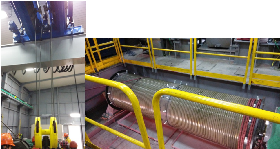
圖 2.2-15 橋式貨櫃起重機機房內配置照#1
