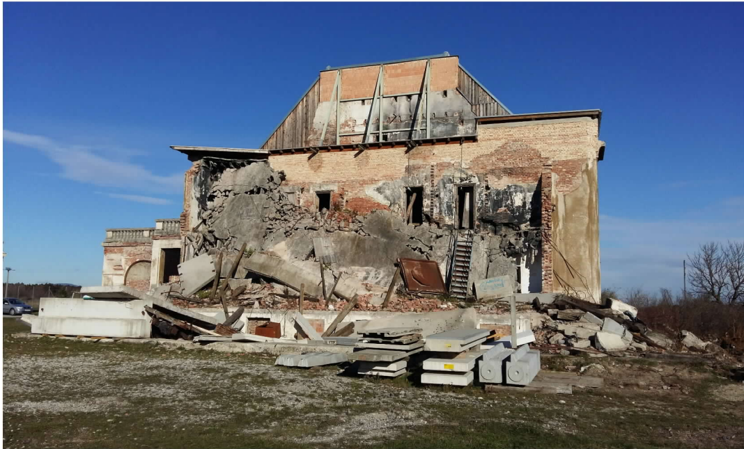
圖 5:半面倒塌建物-第 1 區(地上 3 層、地下 1 層)
