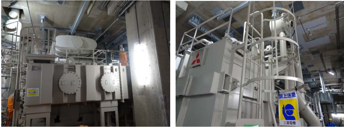
圖21 牛島町地下變電所之地下三樓——275kV/77kV 主變壓器室
