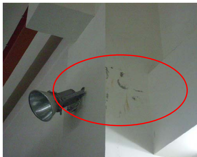
圖4 本公司變電所內牆汗損情形
