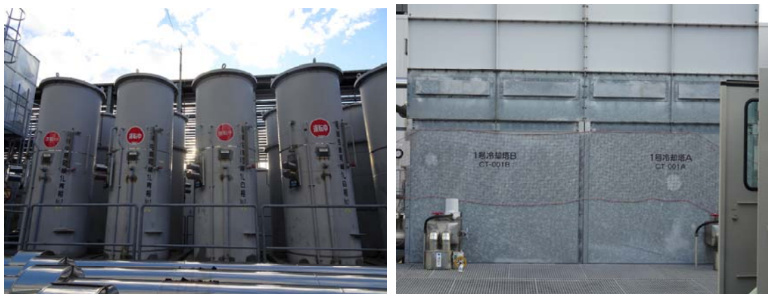
圖27 牛島町地上變電所之頂樓——冷卻水塔裝置(1)
