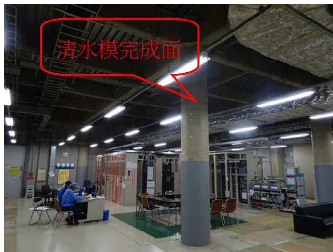
圖26 牛島町地上變電所之地下一樓——控制室
