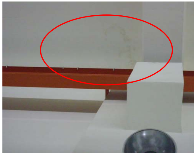
圖3 本公司變電所內牆滲水水漬情形
