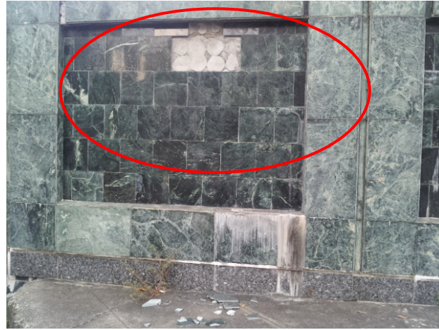
圖2 本公司某單位外牆磁磚脫落情形
