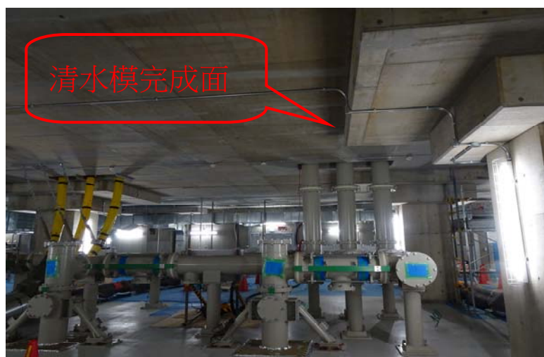
圖20 牛島町地下變電所之地下二樓——電力電纜室
