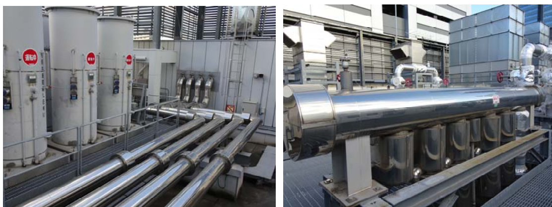
圖28 牛島町地上變電所之頂樓——冷卻水塔裝置(2)
