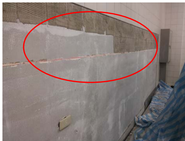
圖1 本公司變電所內牆磁磚脫落情形
