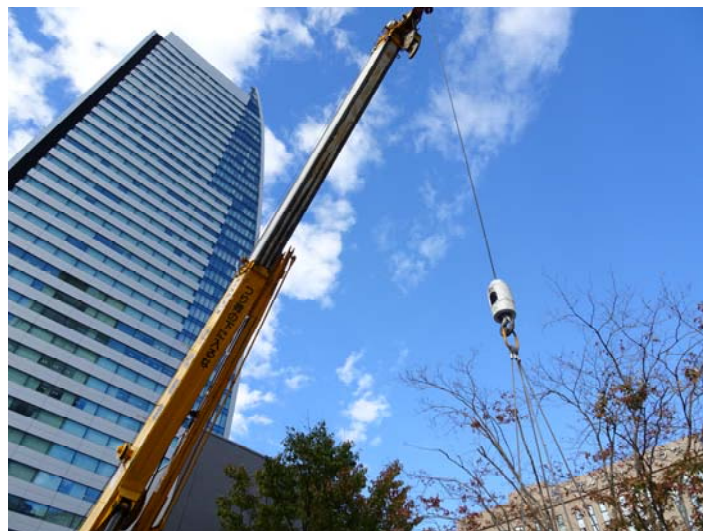
圖14 起重機之掛鉤均設置防滑舌片
