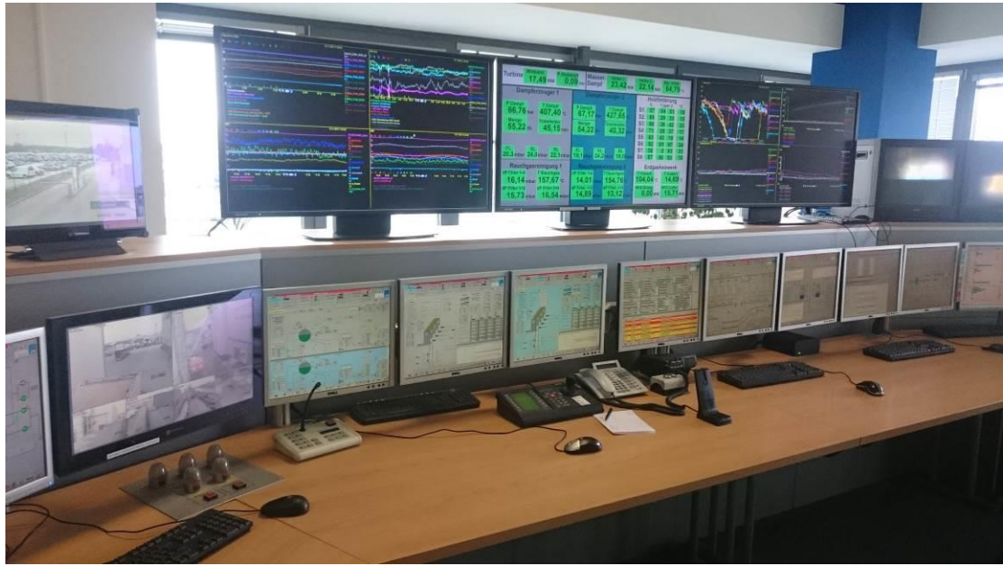
圖 18 RWE 發電廠 SCADA
