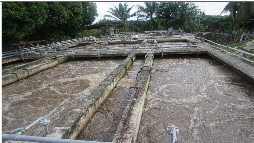
圖二：養豬場廢水處理設施
