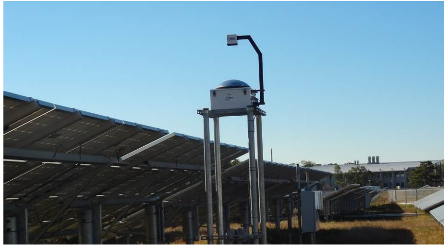
圖 29、太陽能發電廠之氣象監測站
