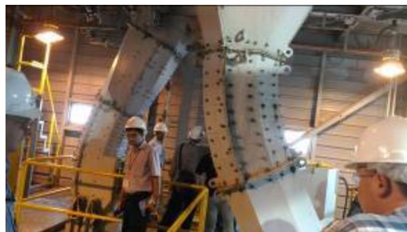
轉送塔密封斜槽（chute）
