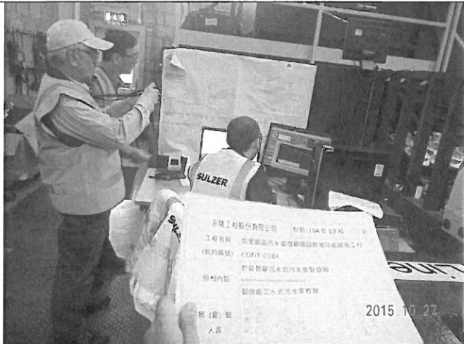
設備檢驗測試電腦曲線監控
