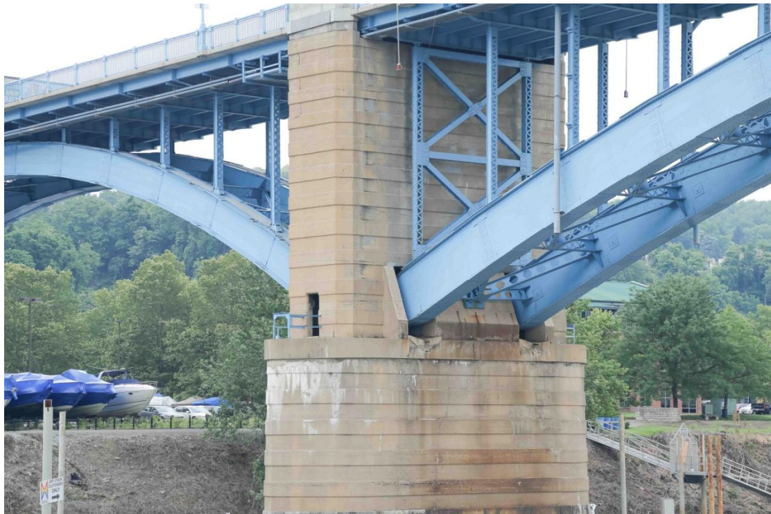
圖 46 匹茲堡當地公路橋橋墩混凝土塊剝落之情形
