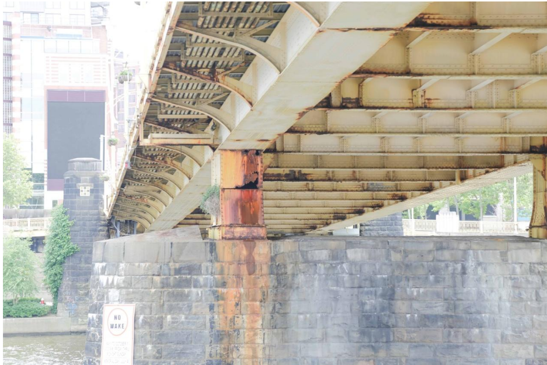
圖 45 匹茲堡當地公路鋼構橋橋支承嚴重鏽蝕之情形
