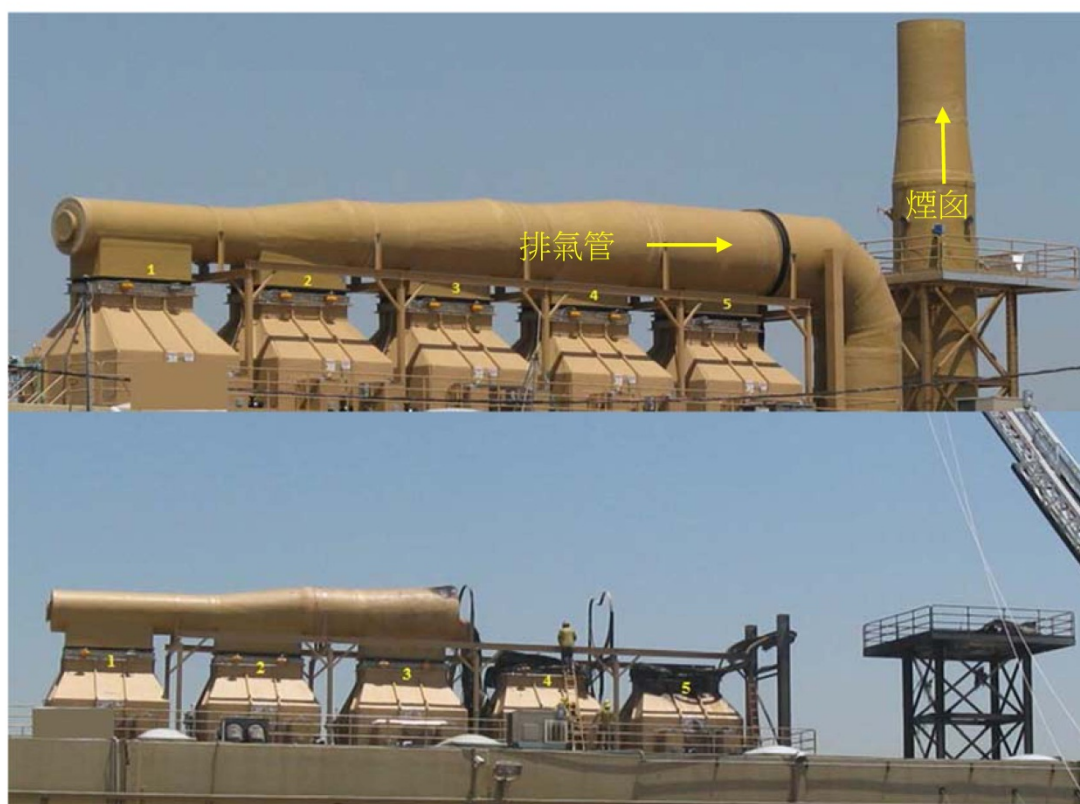
圖 12 上為火災前、下為火災後，4 號及 5 號的排氣管燒掉，煙囪則被燒至底部 (資料來源：IAAI 2015 ITC)
