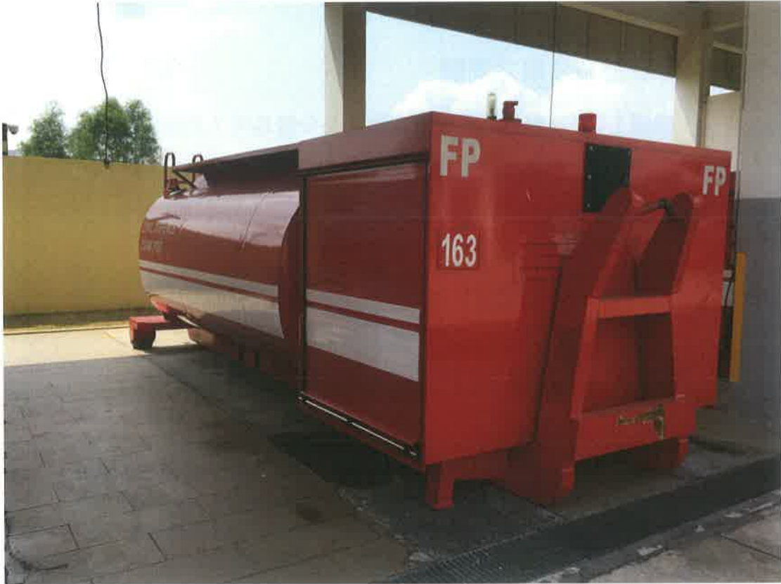
圖 3.20、大流量砲塔車備用之泡沫原液（資料來源：本次參訪拍攝照片）
