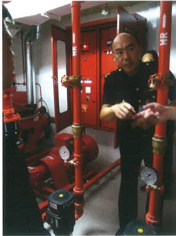
圖 31-測試緊急發電機啟動狀態下，消防安全設備作動情形。
