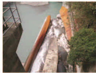
写真1 排砂ゲートの摩耗(天輪ダム)
