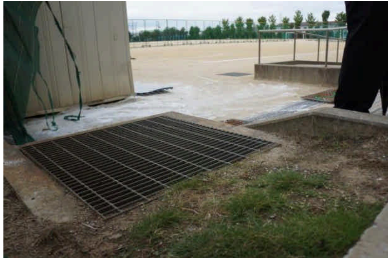
出流管制設施(操場の出流管制)
