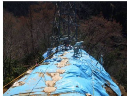
(現在の状況: 応急対策実施済み)
