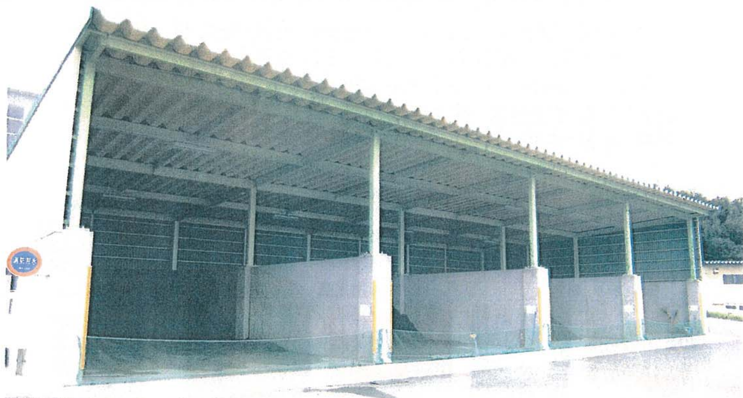
7.5m × 14.5m × 4区画 (1区画で約380トン 1ヶ月分のスラグを貯留)(合計4ヶ月分を保管) 豊田市渡刈クリーンセンター
