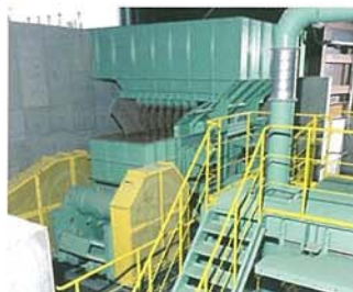
コンクリート処理施設
