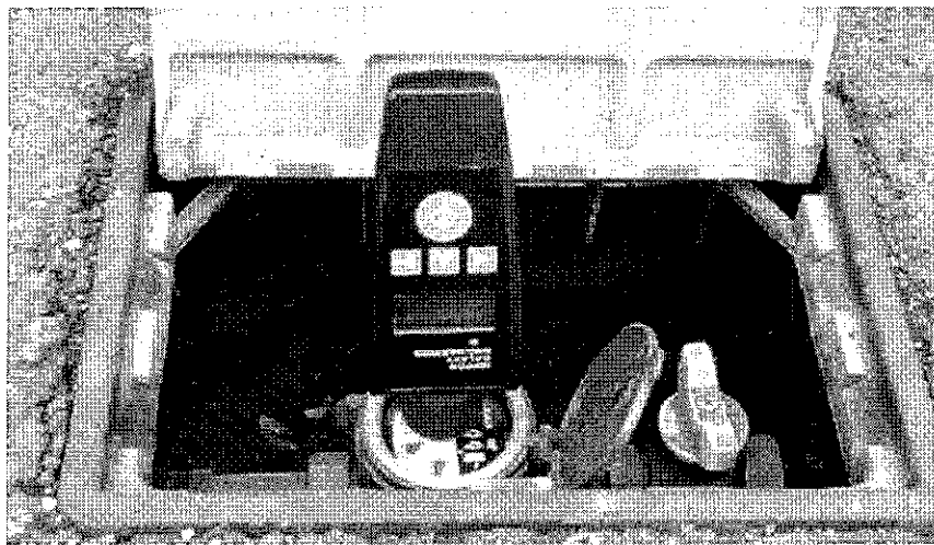
圖 3.3.3.4 積分式漏水探知器
