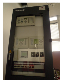
圖 15 展示間 GIS 設備控制盤
