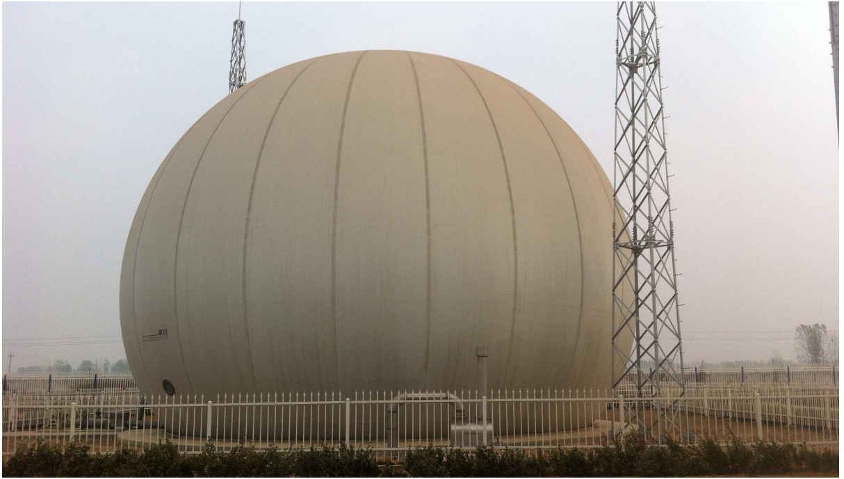
圖 7 雙膜式甲烷貯氣槽
