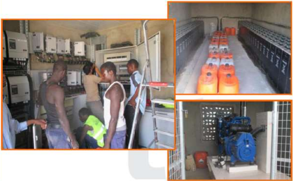
圖86 柴油發電機與電池實景照
