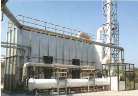
盐城某企业 RTO 焚烧炉现场
