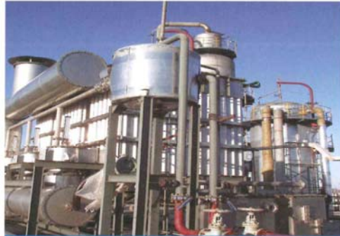
盐城某企业现场溶剂回收
